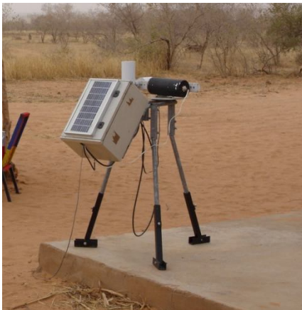
Utilisation de panneau solaire
